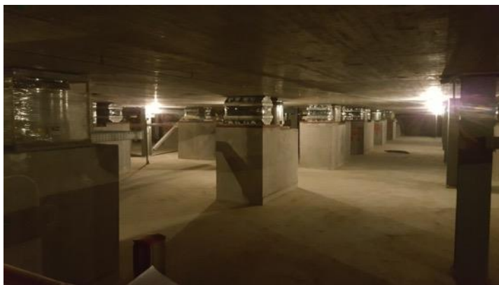
Figura 5: Imagine de la subsolul clădirii speciale ELI-NP arătând stâlpii de susținere cu arcuri și amortizare a platformei antivibrație.
