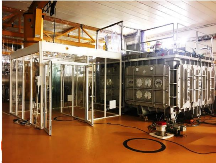
Figura 4: Sala experimentală E1 este dedicată experimentelor de fizică nucleară cu pulsuri laser de 10 PW.
